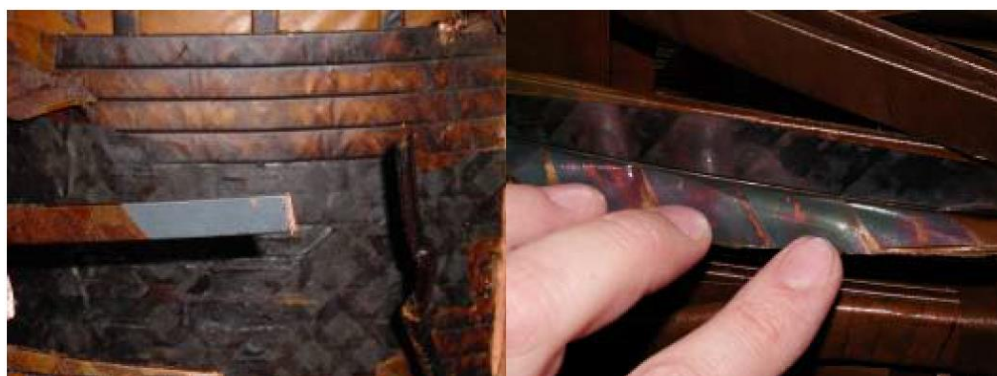
Rysunek 3.10. Przykładowe osady siarczku miedzi na uszkodzonych transformatorach [32]
