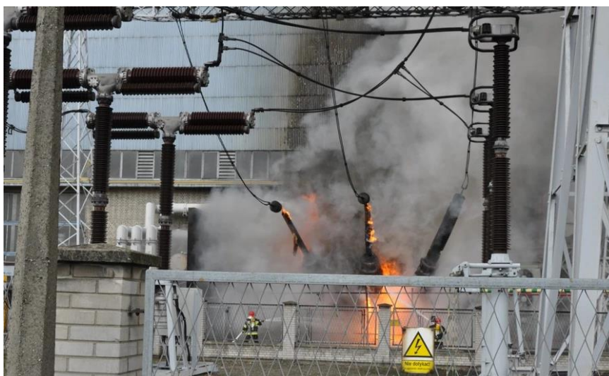
Rysunek 2.4. Pożar transformatora blokowego w Elektrowni Rybnik [90]
