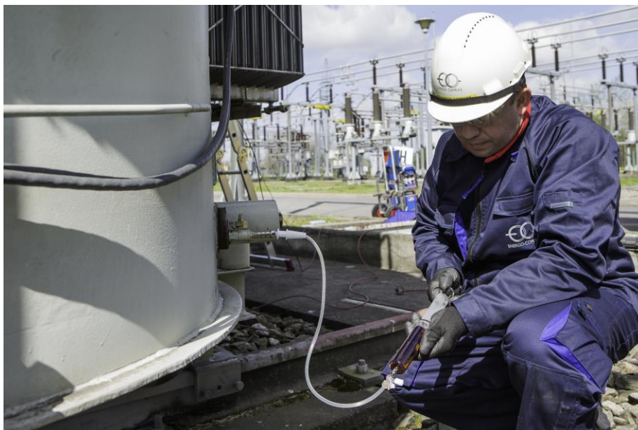
Rysunek 4.1. Pobór oleju z transformatora w celach diagnostycznych (metoda DGA); Materiał wykorzystany za zgodą firmy Energo-Complex
