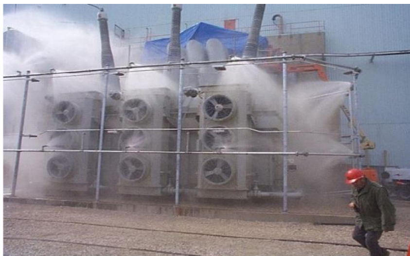
Rysunek 1.7. Stanowisko gaszeniowe transformatora [36]
