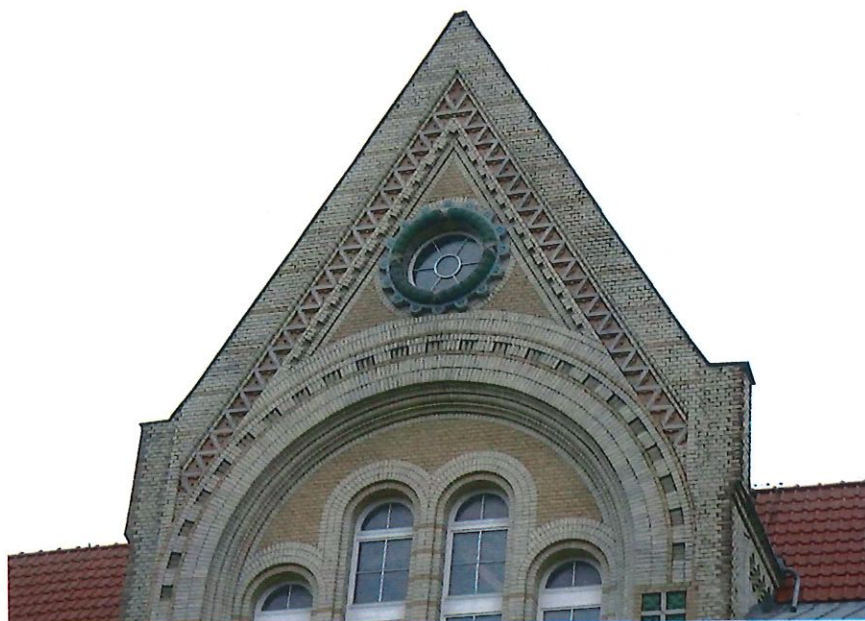
2. Szczyt ryzalitu środkowego. Widoczne zanieczyszczenia atmosferyczne oraz przebarwienia cegieł spowodowane penetracją wody.
