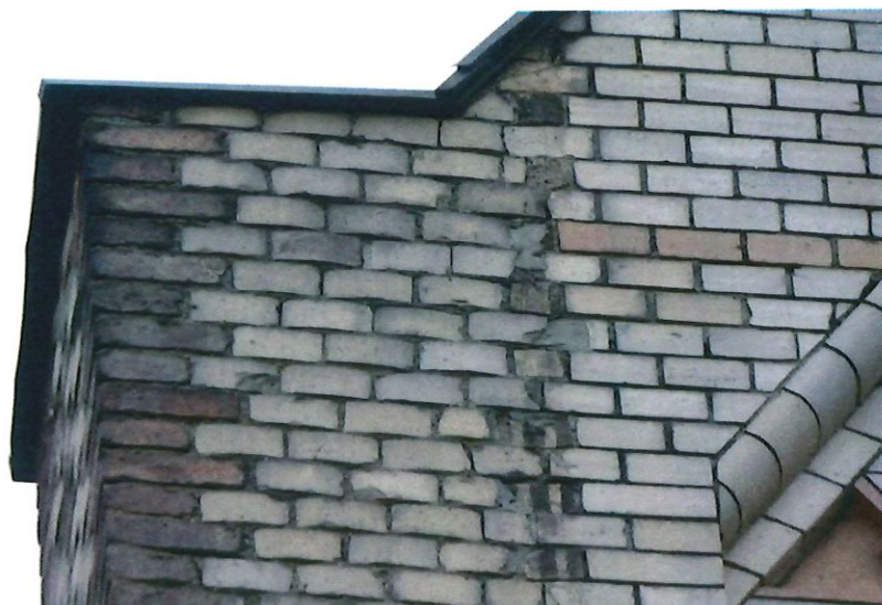
6. narożnik ryzalitu. Uszkodzone krawędzie i lico cegieł. Widoczne cementowe uzupełnienia spoiny.
