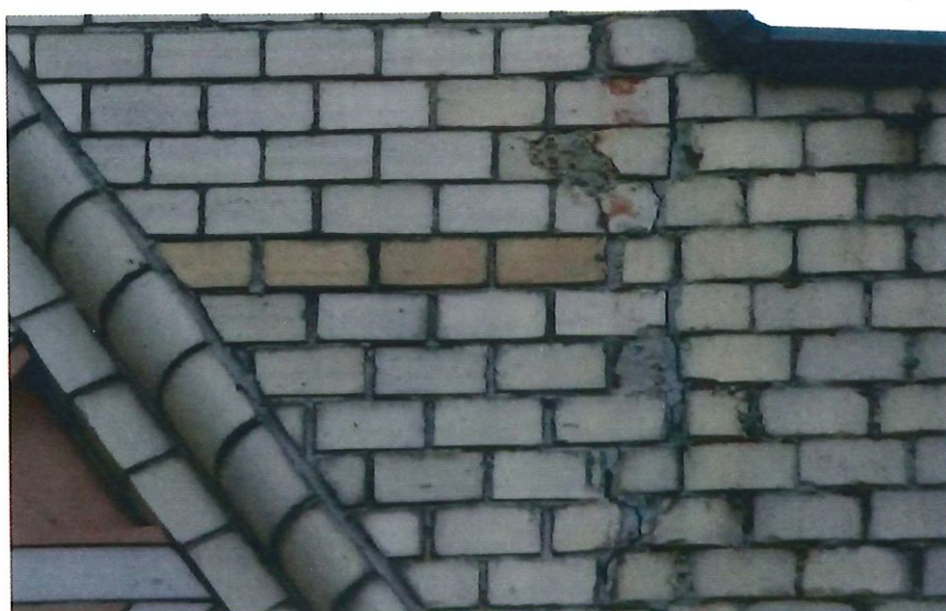
8. Widoczne pęknięcia, uszkodzone spoinowanie oraz uzupełnienia cementowe.
