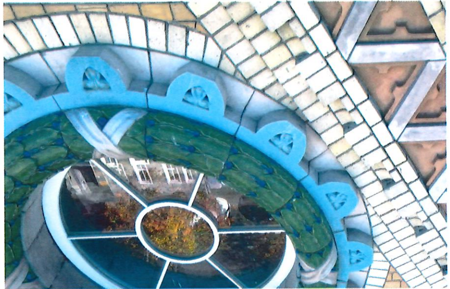
9. Nieszczelności pomiędzy elementami ceramicznymi.
