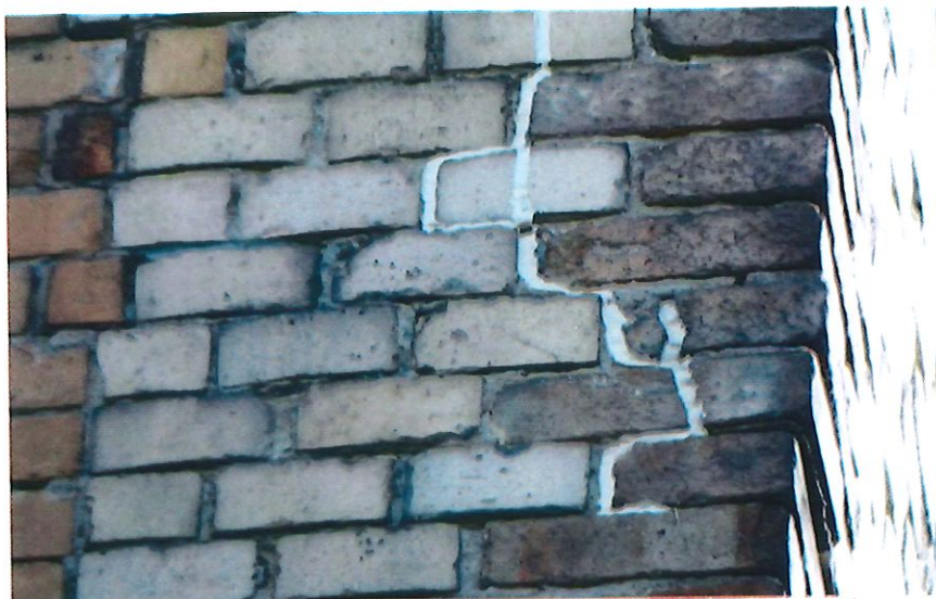
5. Uszkodzone krawędzie cegieł. Widoczne cementowe uzupełnienia spoiny oraz uszczelnienia masą silikonową.
