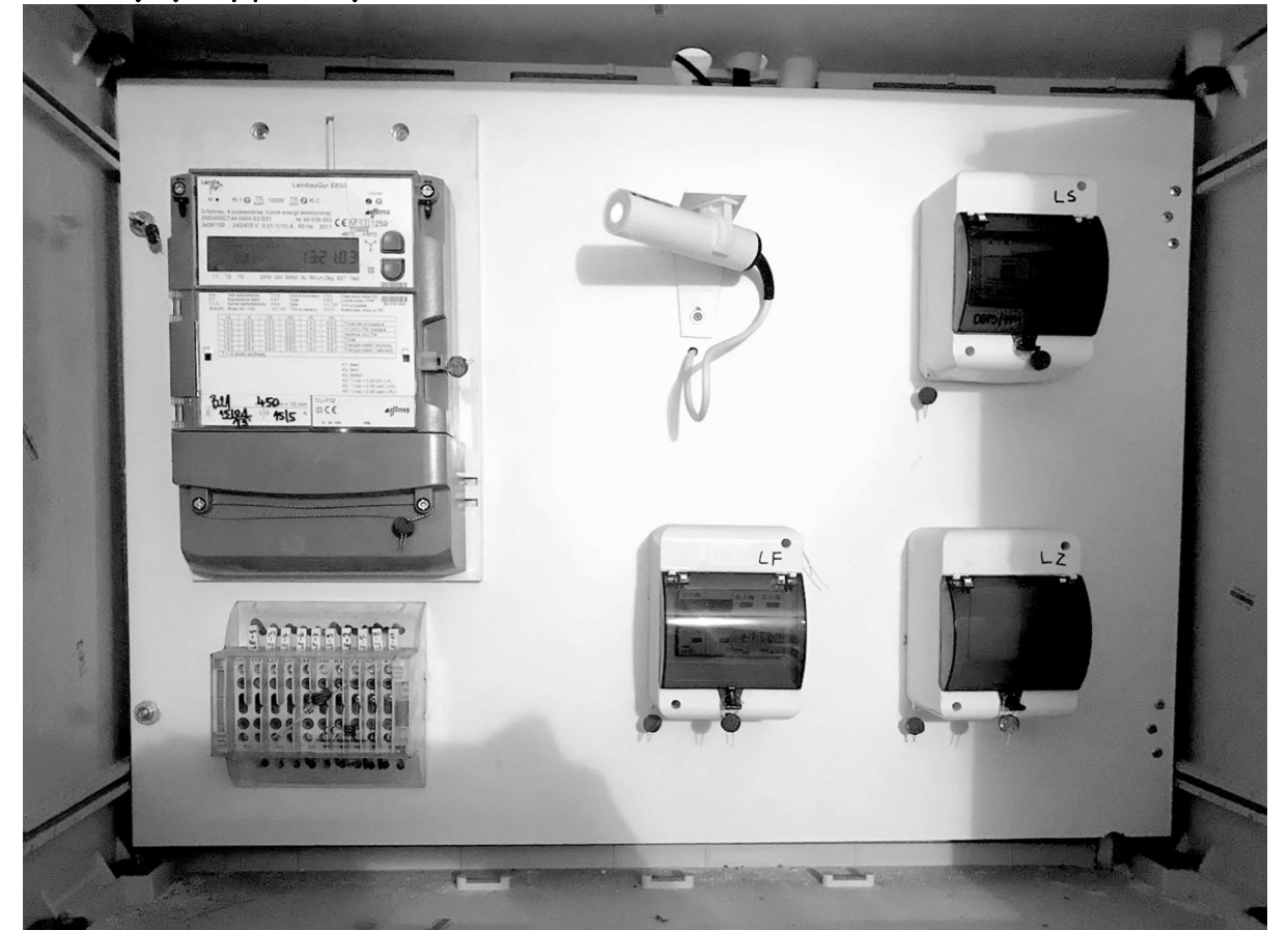
Widok istniejącej szafy pomiarowej
