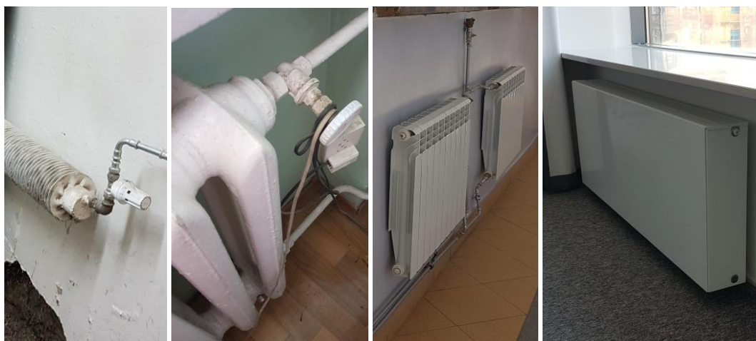
Rys. 7. Przykłady grzejników zainstalowanych w budynku
