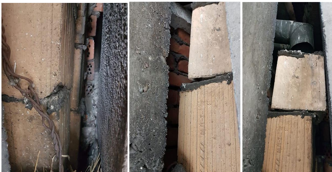
Rys. 6. Widok na szczelinę dylatacyjną pomiędzy segmentami A i H
