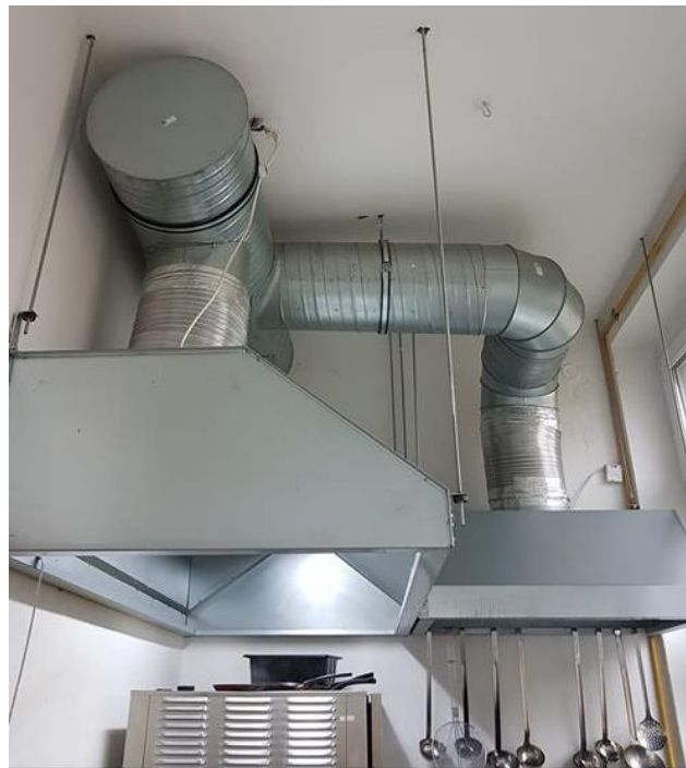
Rys. 11. Wyciąg z kuchni przemysłowej
