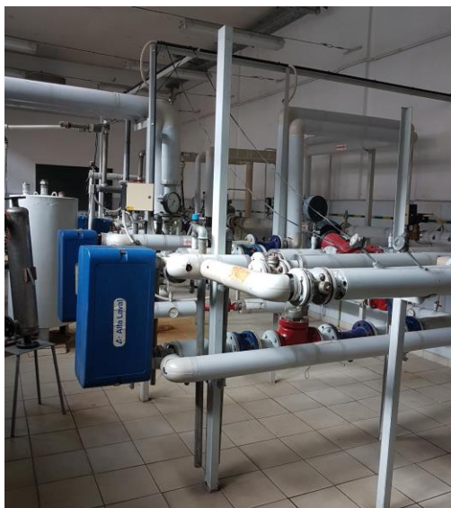
Rys. 8. Widok na pomieszczenie węzła cieplnego
