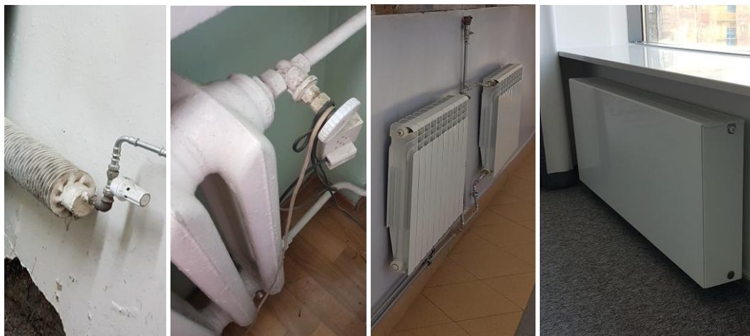
Rys. 7. Przykłady grzejników zainstalowanych w budynku
