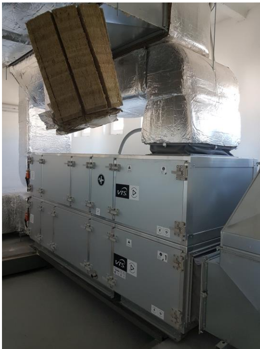
Rys. 10. Widok centrali wentylacyjnej obsługującej czytelnicy wydziałową
