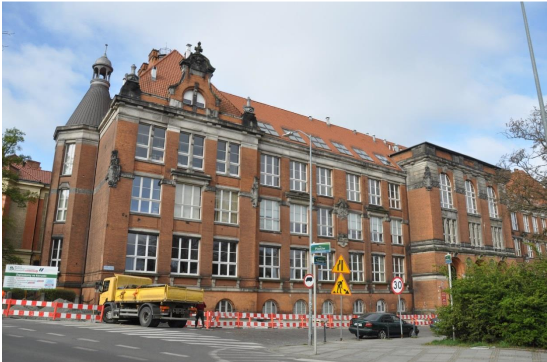
Fot. 5 Dawny budynek Królewskiej Szkoły Budowlanej (Königliche Baugewerkschule). Elewacja frontowa, północno-wschodnia. Stan zachowania w lutym 2020 r. Zmieniona forma dachu w środkowym ryzalicie.
