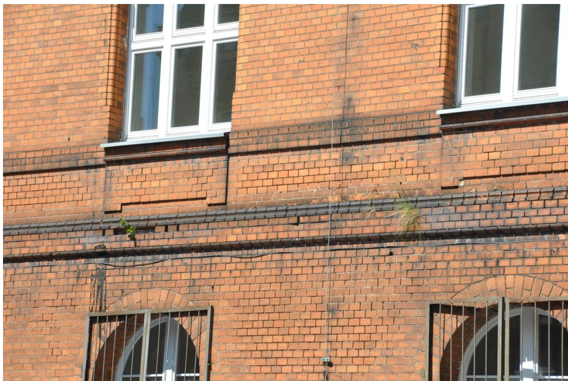
Fot. 71. Elewacja tylna: wypłukane spoiny, szkodliwy rozwój roślinności.
