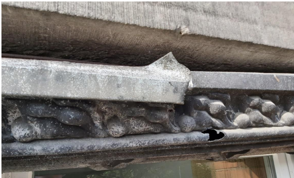
Fot. 45 Dekoracja w nadprożach okien: powtarzający się w różnych oknach motyw różg liktorskich i liści wawrzynu. Wykonana z blachy cynkowo – ołowiowej. Lokalne uszkodzenie mechaniczne.
