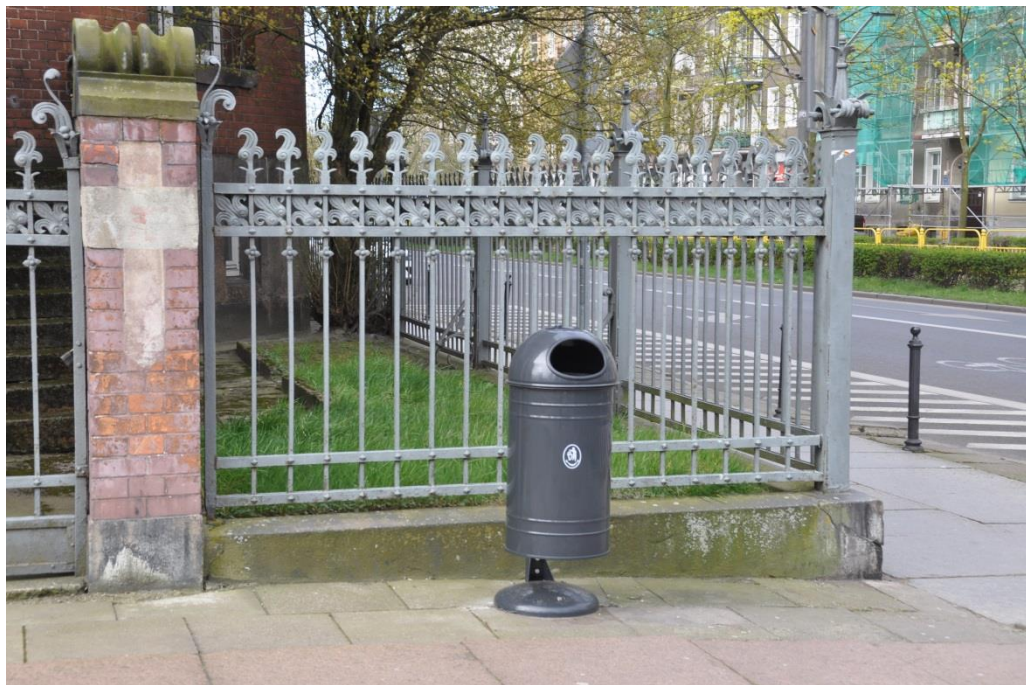
Fot. 73. Elewacja frontowa: ogrodzenie. Słupek ceglany pomalowany wtórną, łuszczącą się farbą. Glony porastające cokół, pęknięty narożnik cokolu.
