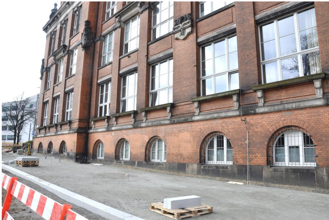
Fot. 51. Elewacja frontowa: cokół obłożony okładziną granitową. Wtórne kraty w oknach w przyziemiu.
