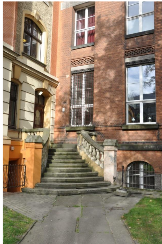
Fot. 9. Dawny budynek Królewskiej Szkoły Budowlanej (Königliche Baugewerkschule). Elewacja boczna, południowo-wschodnia. Stan zachowania w lutym 2020. Schody prowadzące do dawnej willi dyrektorów szkół (obecnie Rektorat ZUT).
