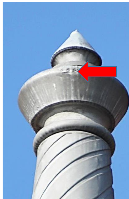
Fot. 20. Elewacja północno-wschodnia, zwieńczenie ryzalitu północnego, wykonane z blachy cynkowej. Widoczna niewielka naprawa.
