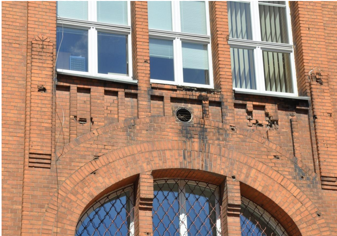
Fot. 72. Elewacja tylna: uszkodzone blaszane i ceglane parapety.
