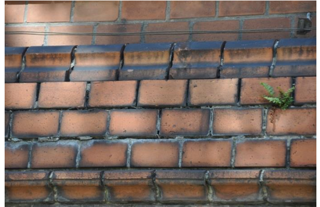
Fot. 67. Elewacja tylna: Wypłukane spoiny w gzymsie międzykondygnacyjnym.
