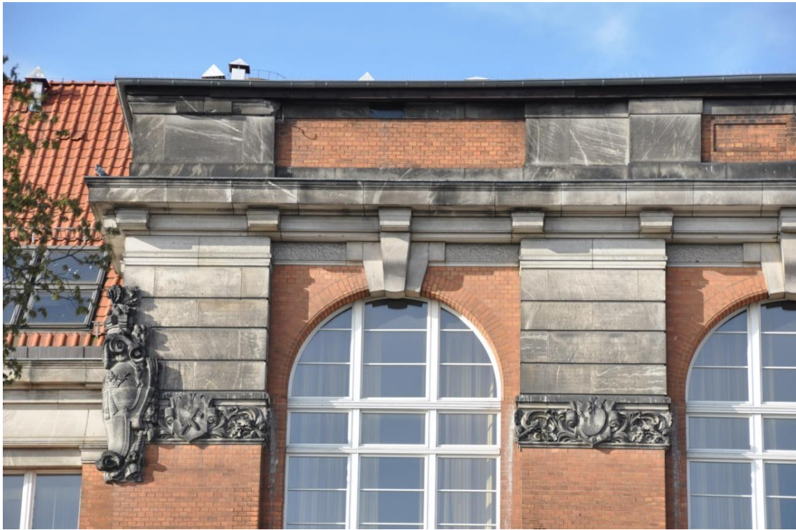
Fot. 32. Część centralna elewacji frontowej, z dekoracyjnymi emblematami nawiązującymi do kierunków kształcenia w dawnej szkole.
