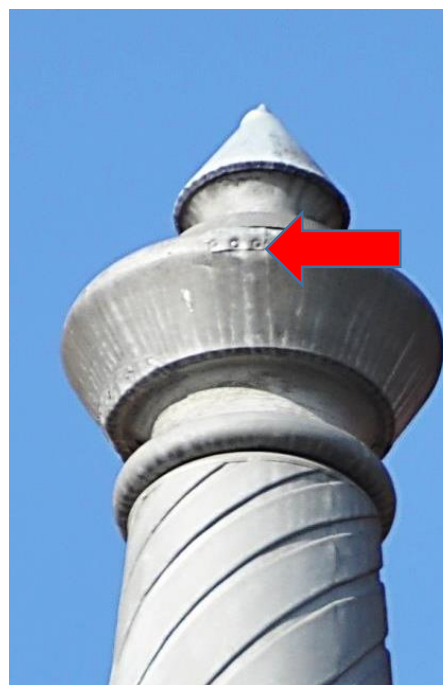
Fot. 20. Elewacja północno-wschodnia, zwieńczenie ryzalitu północnego, wykonane z blachy cynkowej. Widoczna niewielka naprawa.
