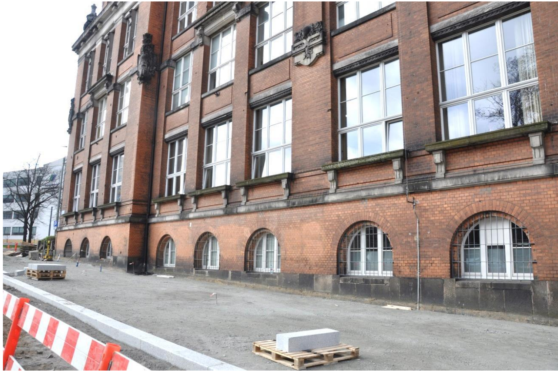
Fot. 51. Elewacja frontowa: cokół obłożony okładziną granitową. Wtórne kraty w oknach w przyziemiu.
