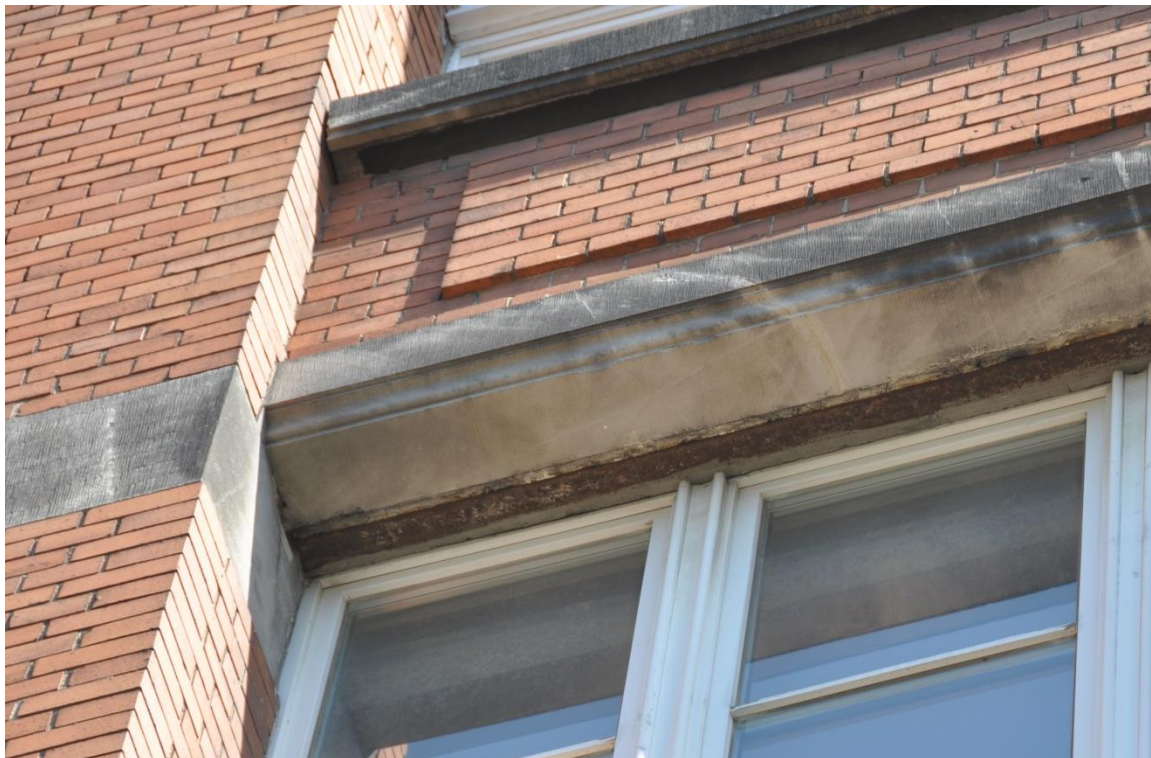
Fot. 70. Stan zachowania stalowych belek nadprożowych w oknach: belki pokryte korozją, niezabezpieczone.
