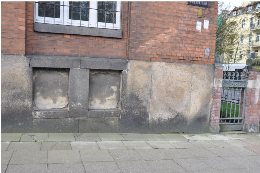
Fot. 52. Elewacja frontowa: cokół obłożony okładziną granitową. Pomędzy oknem a cokołem widoczne ukośnie biegnące rozsunięcie cegieł.
