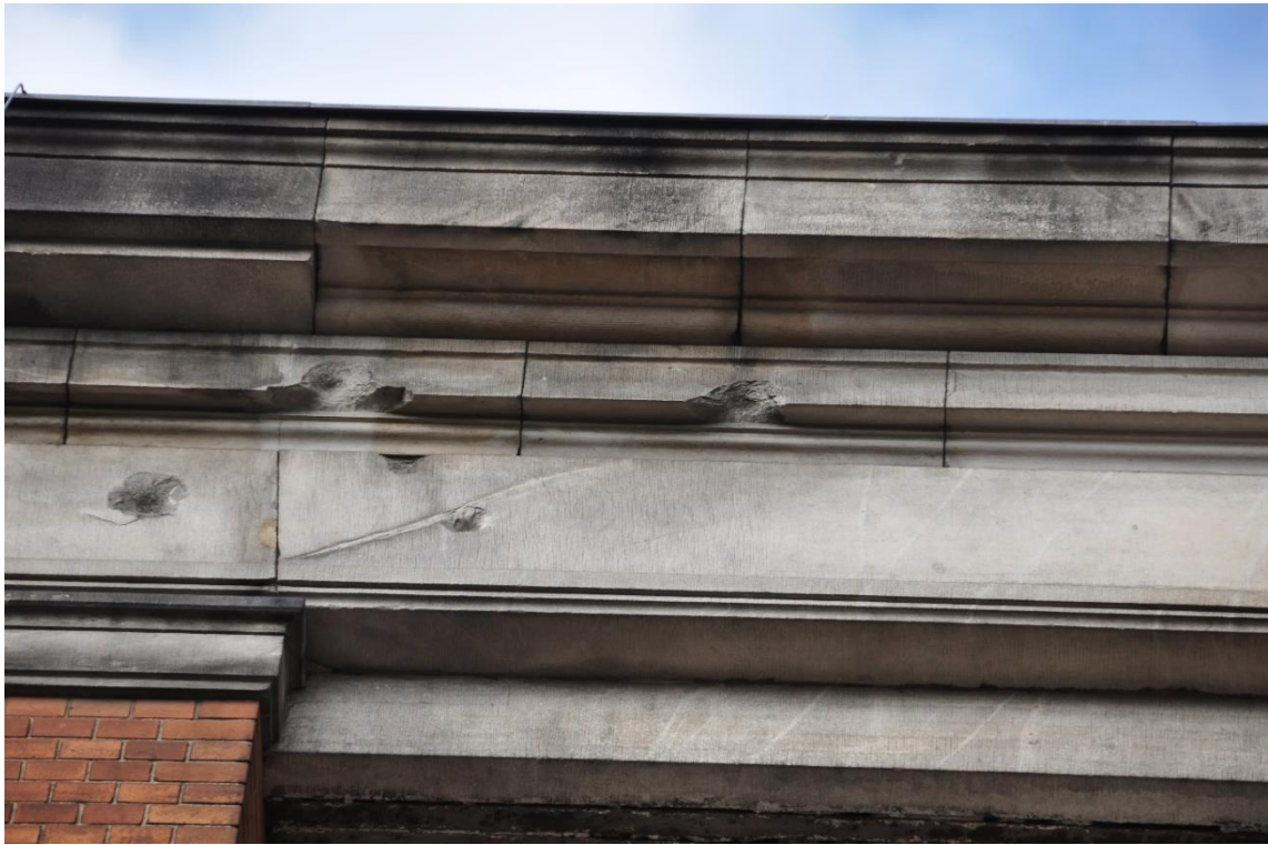
Fot. 64 Elewacja frontowa, gzyms wieńczący. Postrzeliny.
