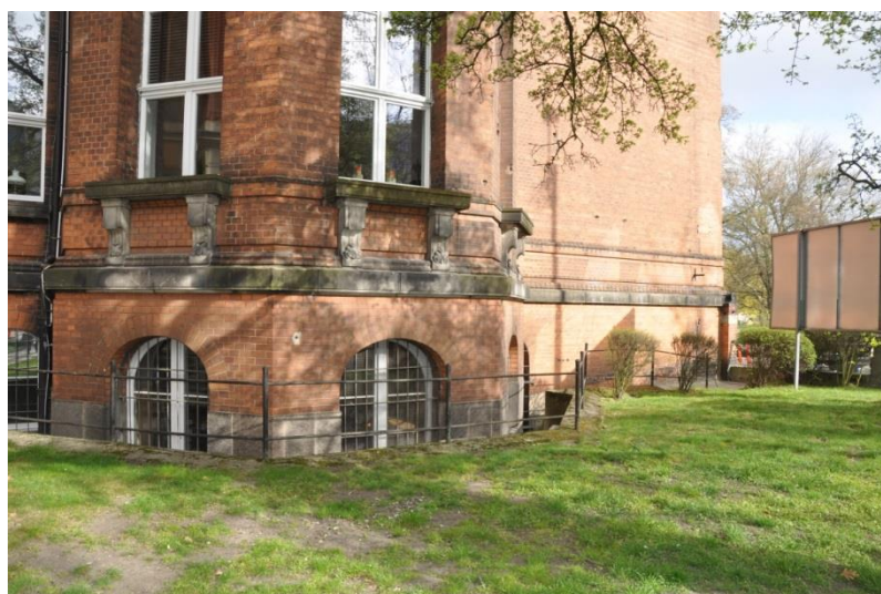
Fot. 10. Dawny budynek Królewskiej Szkoły Budowlanej (Königliche Baugewerkschule). Elewacja frontowa, południowo-wschodnia. Stan zachowania w lutym 2020 r. Barierka zabezpiecza wtórny kanał doświetlający.
