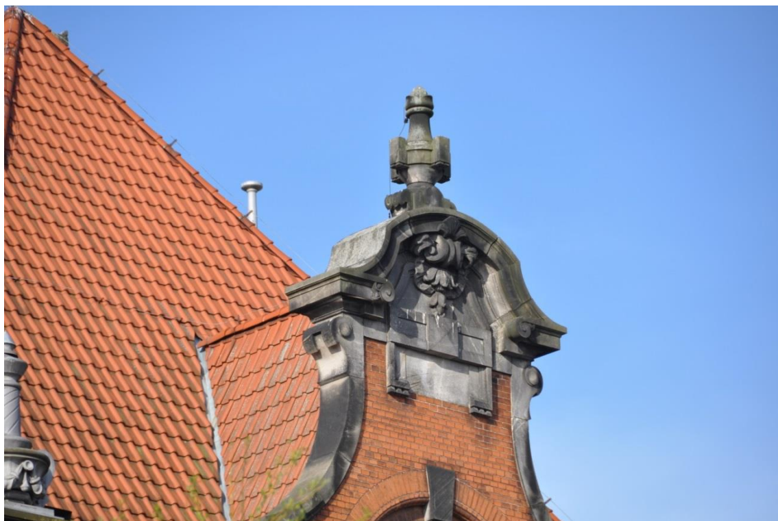
Fot. 18. Elewacja frontowa, północno-wschodnia, zwieńczenie ryzalitu północnego. Dekoracje wykonane z piaskowca.
