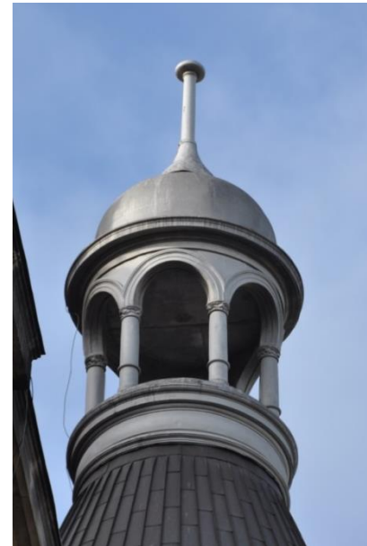
Fot. 22. Elewacja północno – zachodnia. Ozdobne kolumnienki, wykonane z blachy cynkowej, w galeryjce na zwieńczeniu ryzalitu.
