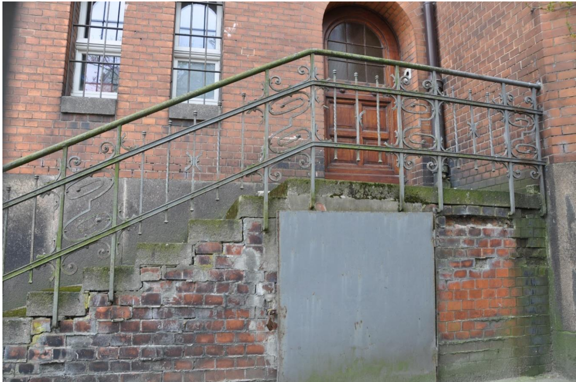
Fot. 58. Elewacja północno – zachodnia (od strony ul. Sikorskiego). Zły stan zachowania schodów.
