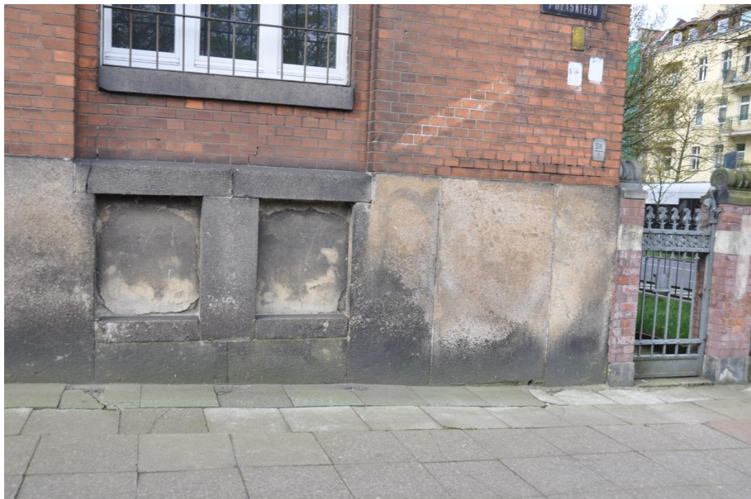
Fot. 52. Elewacja frontowa: cokół obłożony okładziną granitową. Pomędzy oknem a cokołem widoczne ukośnie biegnące rozsunięcie cegieł.
