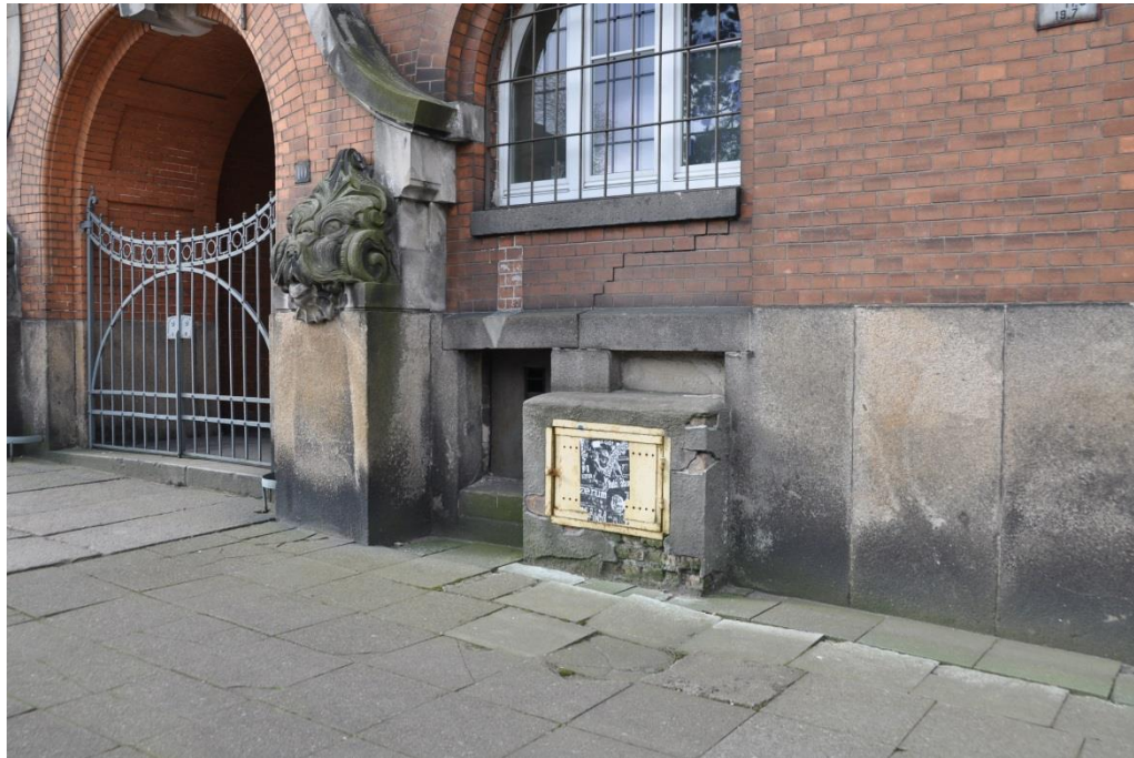
Fot. 53. Elewacja frontowa. Pomiędzy oknem a cokolem widoczne ukośnie biegnące rozsunięcie cegieł. Zniszczona, szpecząca obudowa skrzynki instalacyjnej.
