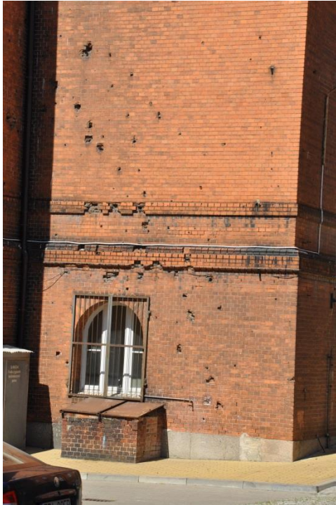
Fot. 66. Elewacja tylna: postrzeliny i ubytki okładziny.
