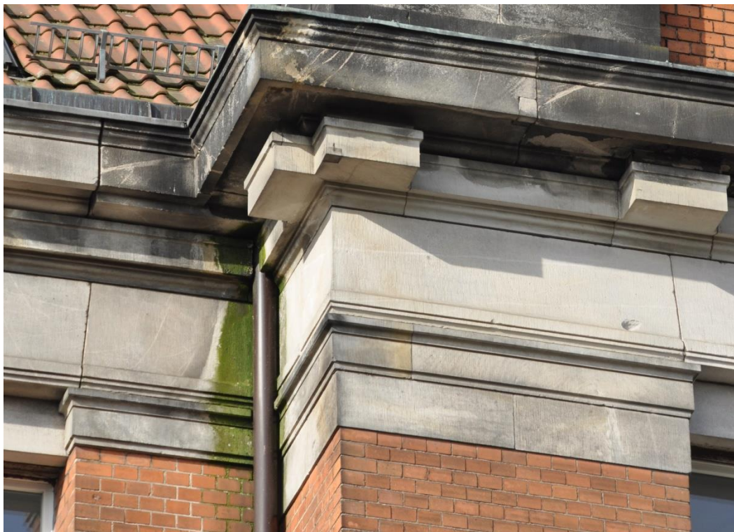
Fot. 48. Elewacja frontowa: wykusz od strony ul. Sikorskiego (północnej), widoczny rozwój glonów w miejscu zalewanym wodą z dachu. Przepuszczalnie niedrożna rura spustowa.
