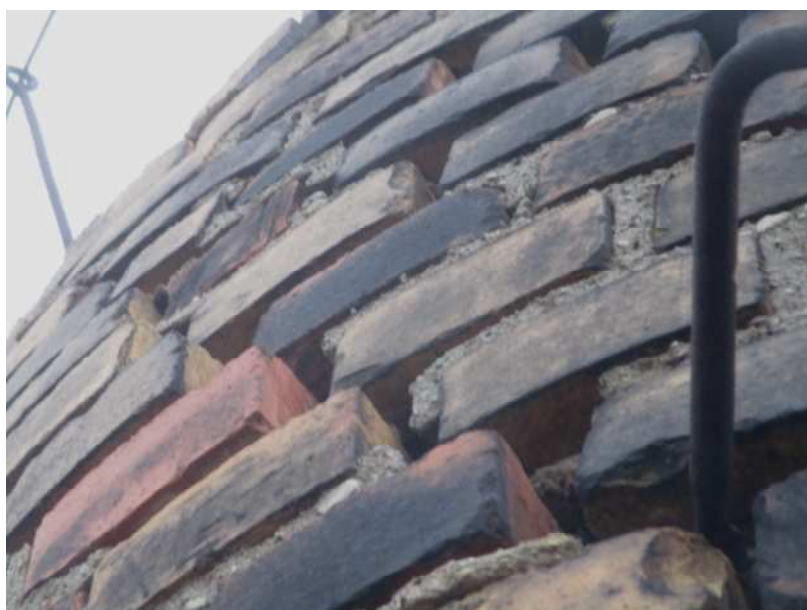
Fot.29.Szczytowy odcinek trzonu komina, pęknięcia, rozluźnienia wiązań
