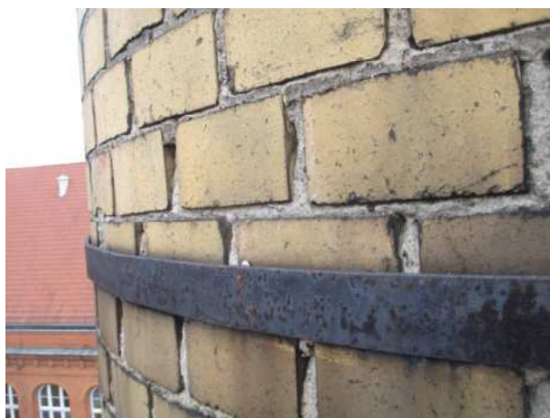
Fot.21.Korodująca obręcz stalowa
