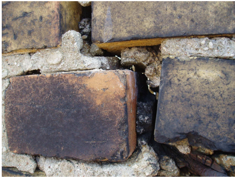
Fot.33.Szczytowy odcinek trzonu komina, pęknięcia, zniszczenie wiązań cegieł
