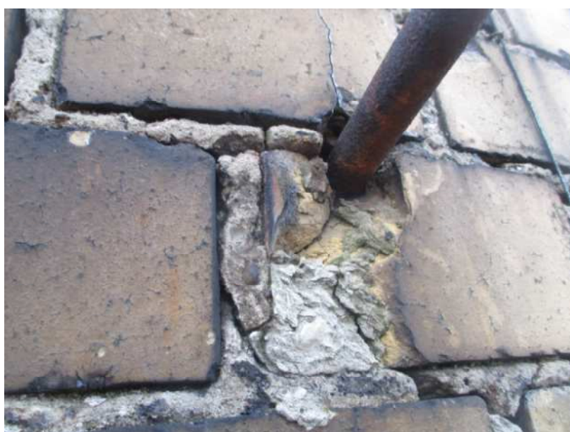
Fot.17.Ukośne i pionowe pęknięcia trzonu
