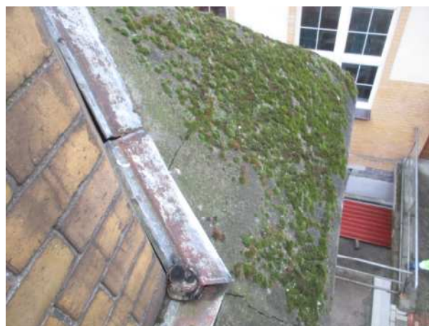
Fot.6.Uszkodzenia zwieńczenia cokołu
