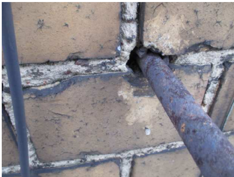
Fot.10. Ubytki przy osadzeniu szczelbi
