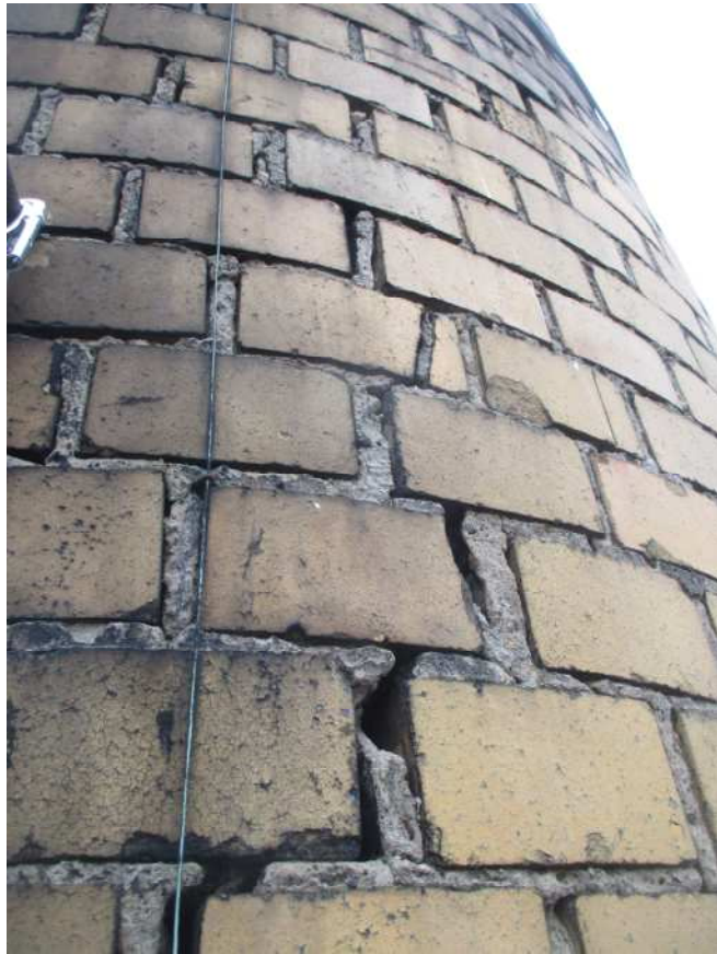
Fot.13.Ukośne i pionowe pęknięcia trzonu
