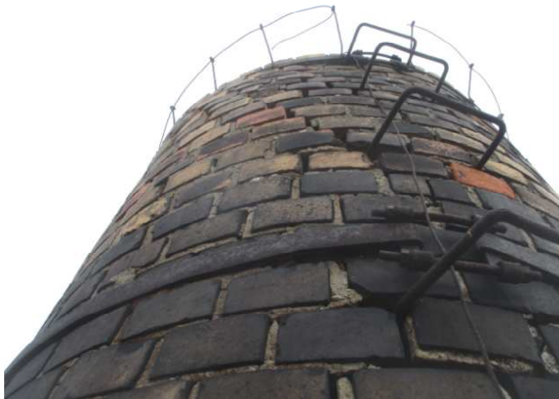
Fot.27.Szczytowy odcinek trzonu komina, skorodowana instalacja odgromowa, rozluźnienia wiązań
