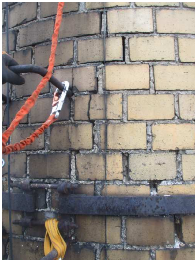
Fot.14.Ukośne i pionowe pęknięcia trzonu
