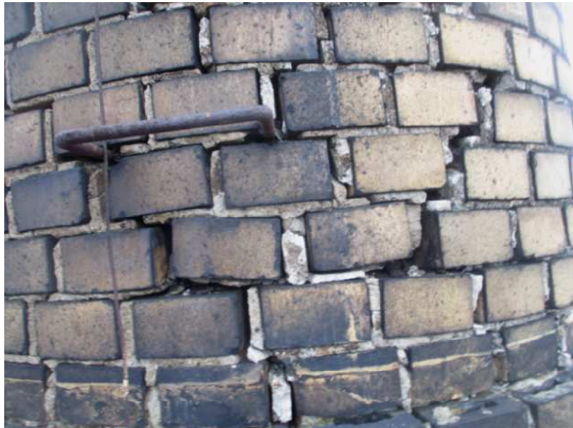
Fot.31.Szczytowy odcinek trzonu komina, pęknięcia, rozluźnienia wiązań
