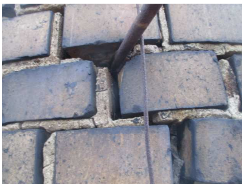
Fot.12. Ubytki i zarysowania przy osadzeniu szczelbi
