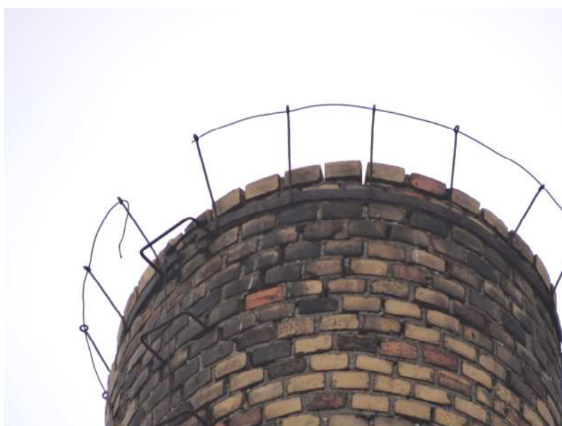
Fot.25.Szczytowy odcinek trzonu komina, zerwany otok odgromowy, rozluźnienia wiązań
