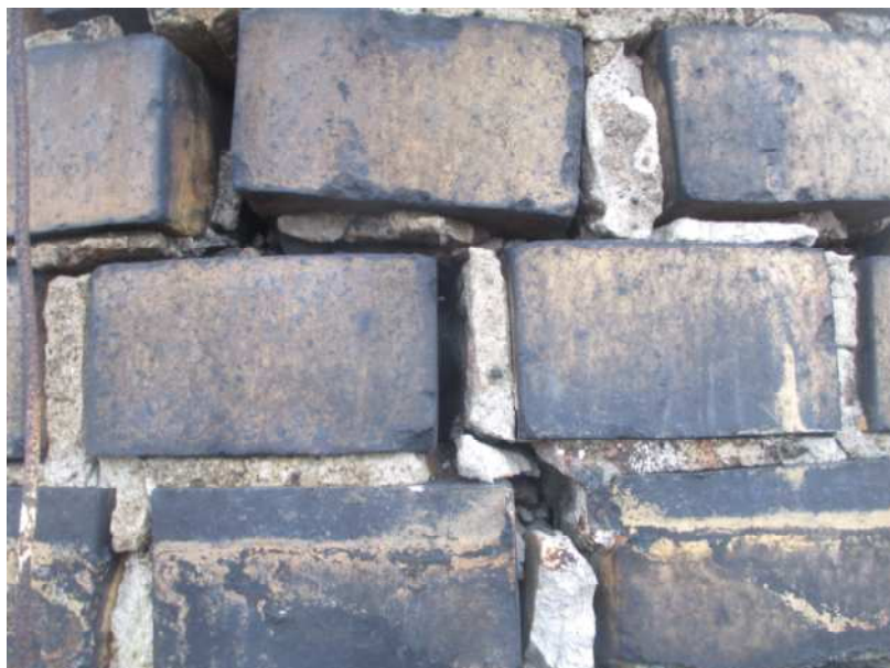
Fot.28.Szczytowy odcinek trzonu komina, pęknięcia, rozluźnienia wiązań
