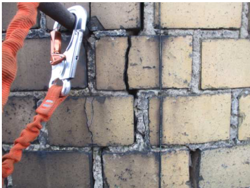
Fot.15.Ukośne i pionowe pęknięcia trzonu
