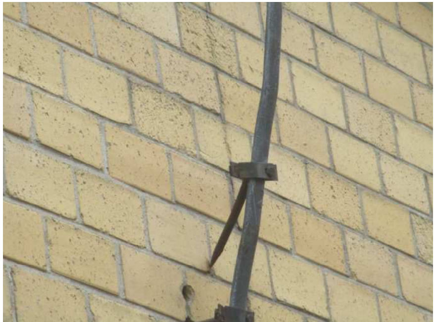
Fot.37.Odspojony zwód instalacji odgromowej
