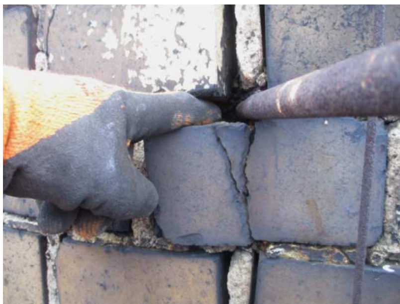
Fot.11. Ubytki i zarysowania przy osadzeniu szczelbi
