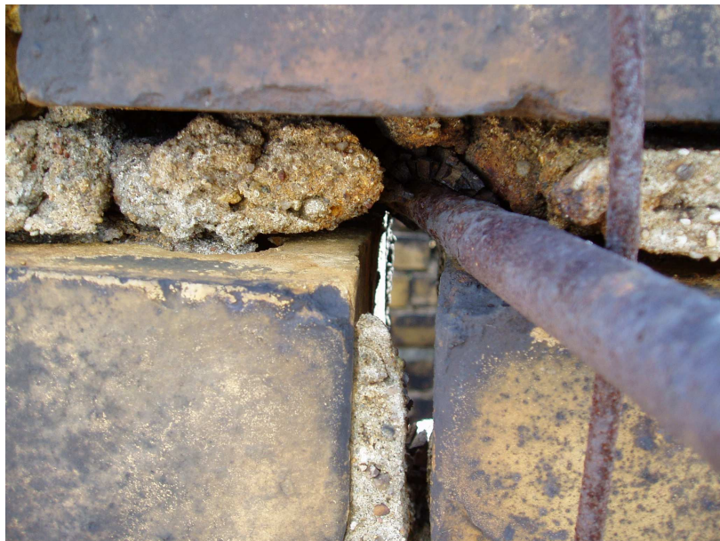
Fot.34.Szczytowy odcinek trzonu komina, pęknięcia na przelot, zniszczenie wiązań cegieł
