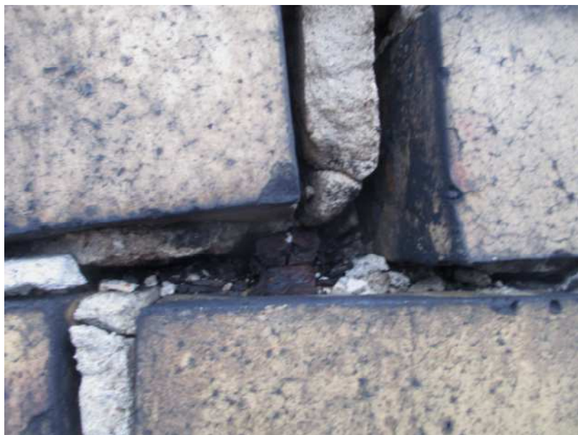
Fot.35.Szczytowy odcinek trzonu komina, pęknięcia , zniszczenie wiązań cegieł
