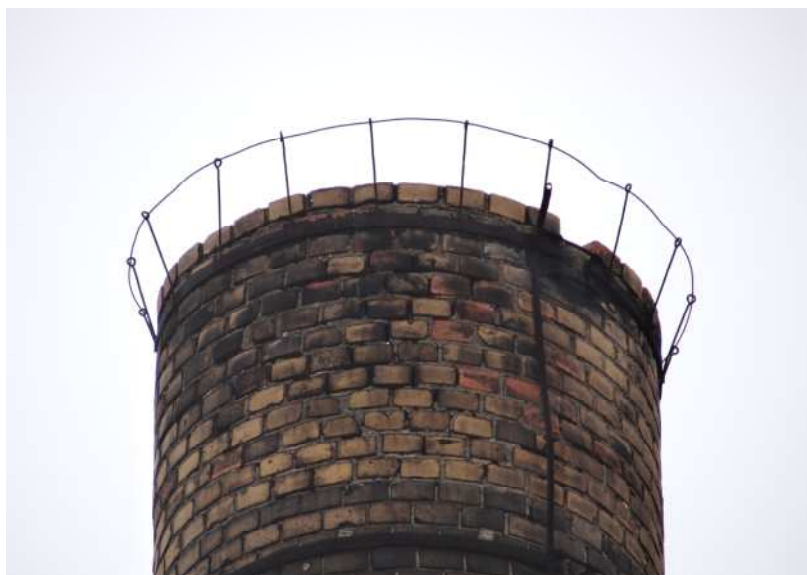
Fot.26.Szczytowy odcinek trzonu komina, skorodowana instalacja odgromowa, rozluźnienia wiązań
