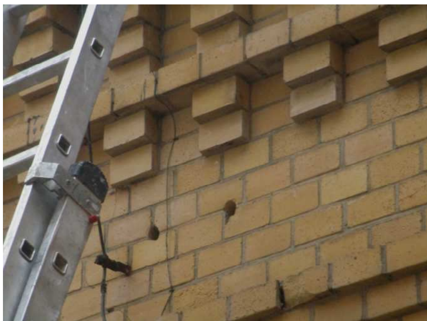
Fot.38. Pozostawione otwory po zdemontowanych kotwach po zdemontowanych konstrukcji wsporczych elementów stacji bazowej sieci T-Mobile
