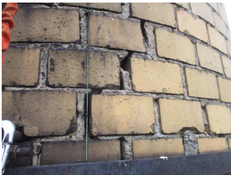
Fot.16.Ukośne i pionowe pęknięcia trzonu
