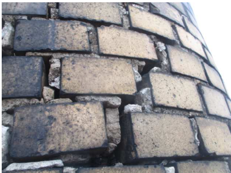
Fot.32.Szczytowy odcinek trzonu komina, pęknięcia, rozluźnienia wiązań
