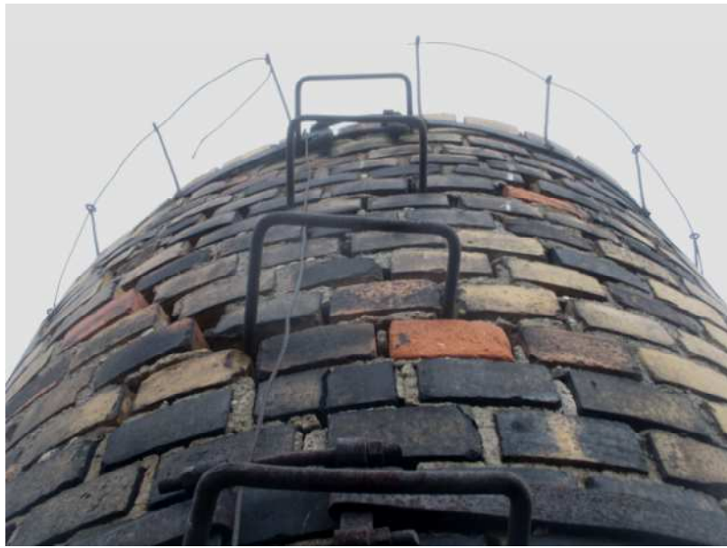
Fot.30.Szczytowy odcinek trzonu komina, pęknięcia, rozluźnienia wiązań
