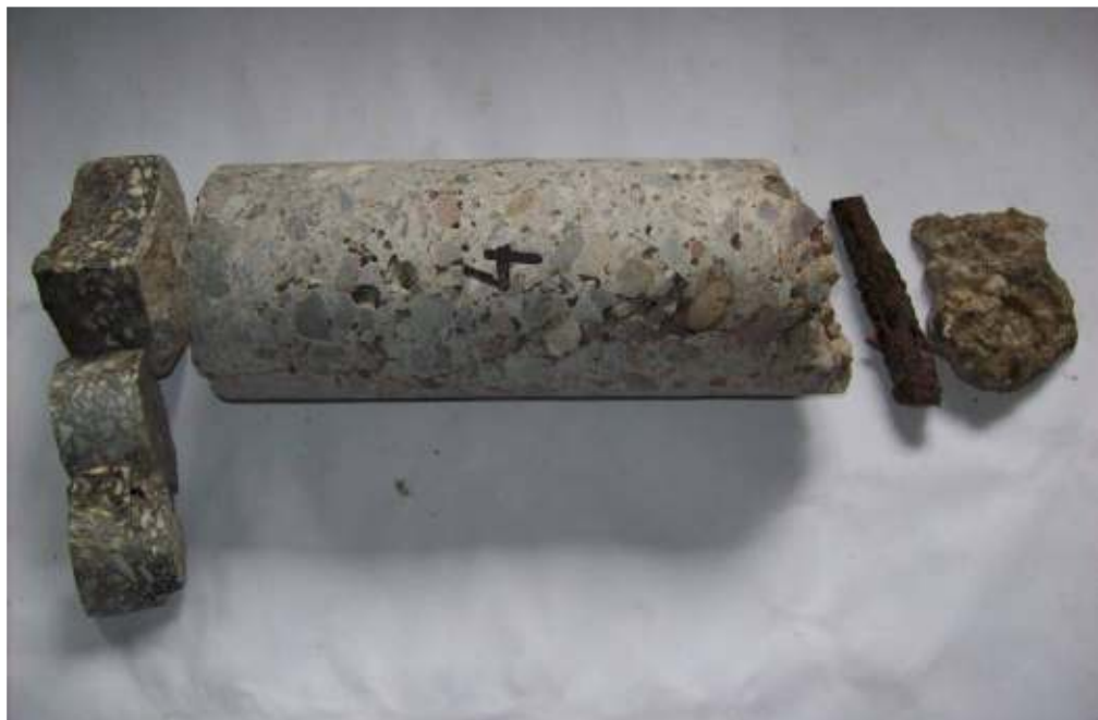
Fot. 39: Odwiert nr 4 o średnicy \varnothing 94 mm: beton od góry jest zagęszczony; od dołu jest porowaty o obniżonej wytrzymałości; warstwa lastryko odspojona od betonu;
