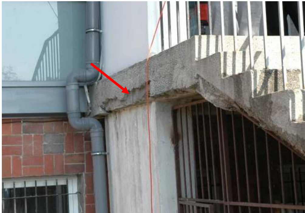
Fot. 12. Fragment biegu schodowego: ubytki okładziny lastrykowej na bocznej powierzchni płyty spocznikowej;
