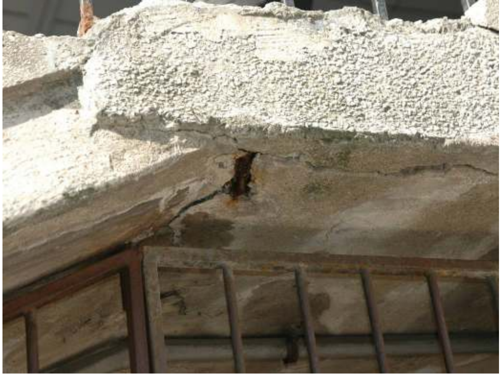
Fot. 16. Fragment spocznika: zawilgocone podniebienie spocznika; zacieki na powierzchni słupa; zarysowania; kalcytowe naloty; kolonie glonów;
