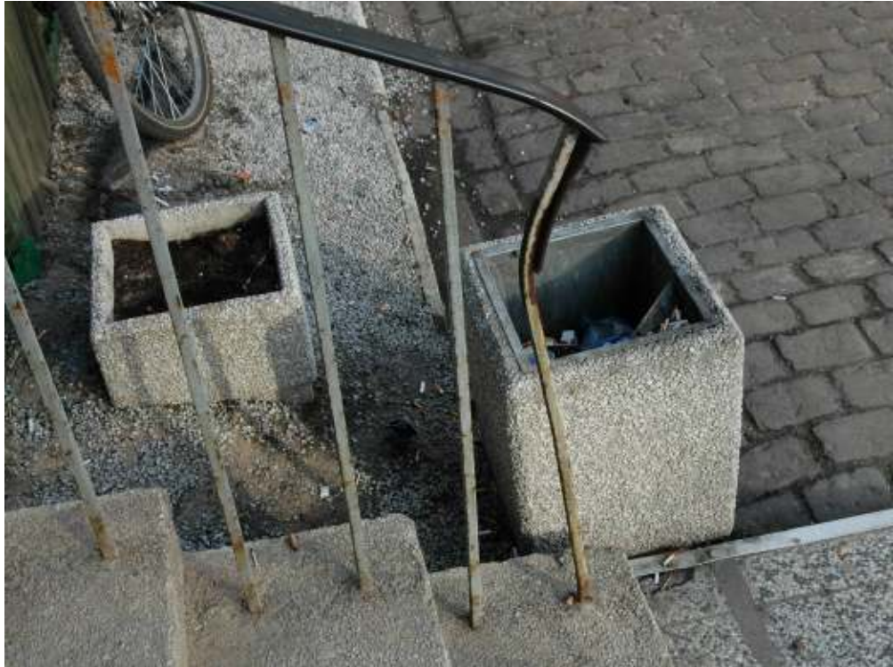
Fot. 30. Fragment balustrady od strony wschodniej: uszkodzenie mechaniczne;
