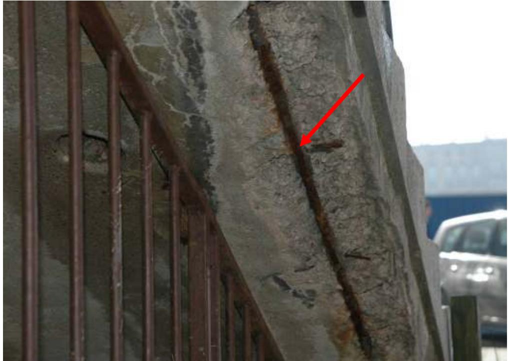
Fot. 10. Fragment biegu schodowego: odsłonięte zbrojenie dolne; pręt \text{Ø}14 do \text{Ø}16 ; pręt skorodowany;
