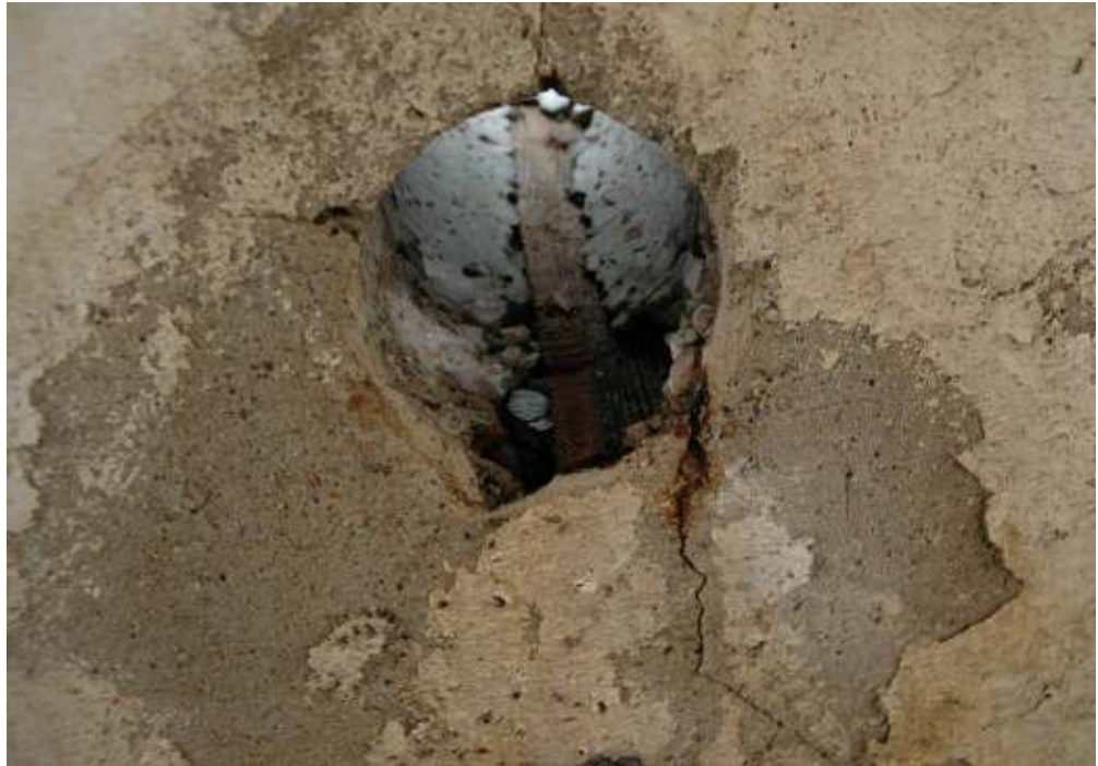
Fot. 24: Odwiert nr 4: w otworze widoczny drewniany element szalunku schodów; tynk zawilgocony, powierzchniowo skorodowany; rdzawe nacieki na powierzchni;
