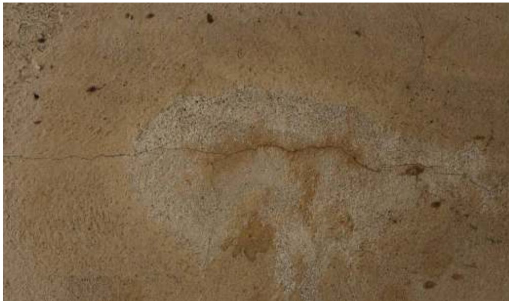
Fot. 20. Fragment podniebienia płyty biegowej: rysa o poziomym przebiegu o rozwarości do 0,5 mm; tynk powierzchniowo skorodowany; złuszczenia farby.
