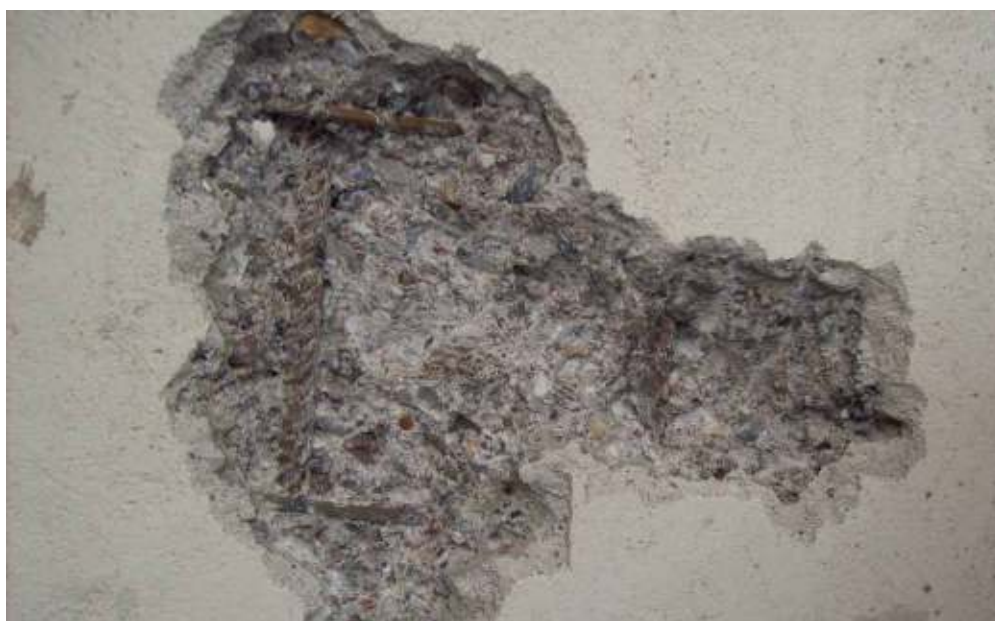
Fot. 32. Fragment podniebienia spocznika: odkrywka zbrojenia;
