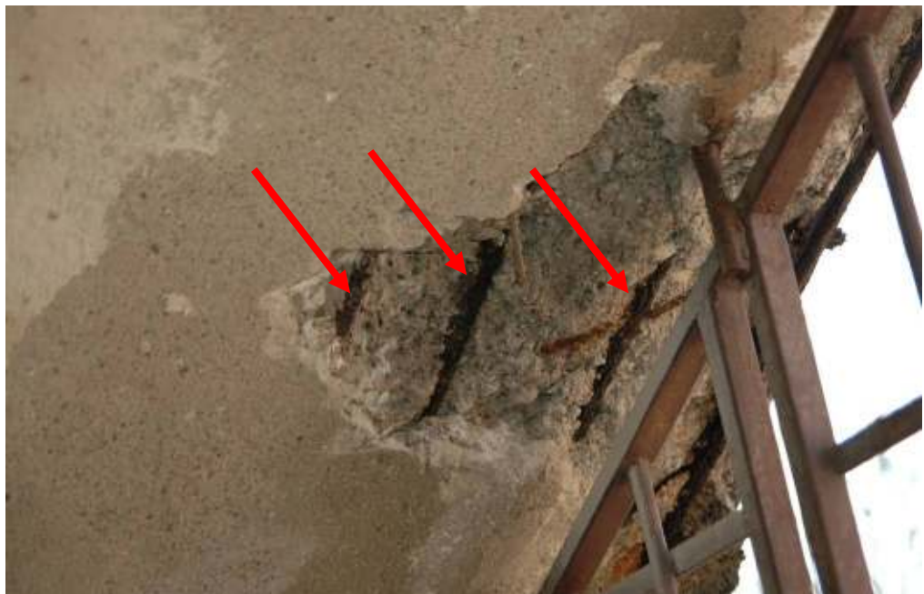
Fot. 11. Fragment biegu schodowego: odsłonięte zbrojenie dolne; pręty \text{Ø}14 do \text{Ø}16 w rozstawie co 13 cm; pręty skorodowane;
