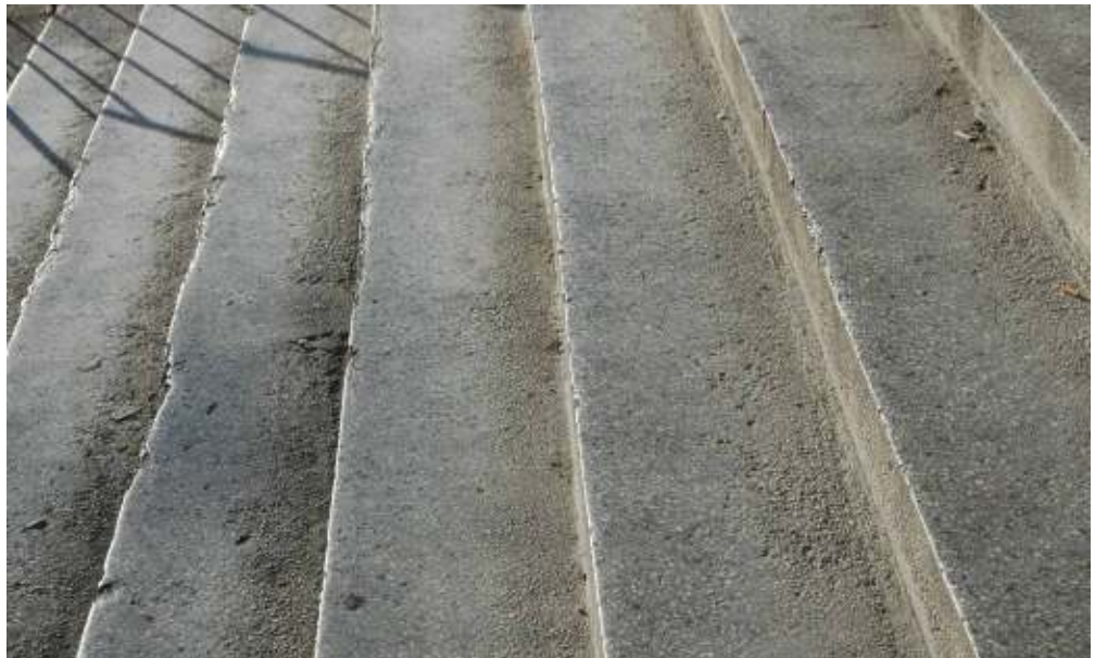
Fot. 3. Widok na stopnie: uszkodzenia na krawędzi stopni
