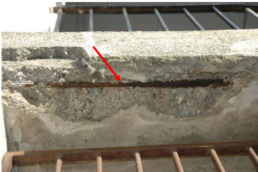
Fot. 13. Fragment płyty spocznika: odsłonięte zbrojenie dolne na krawędzi spocznika
