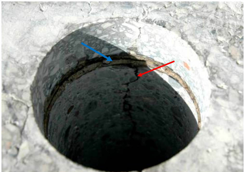
Fot. 5. Odwiert nr 4: pod warstwą okładziny beton zawilgocony; widoczny przebieg pęknięcia
