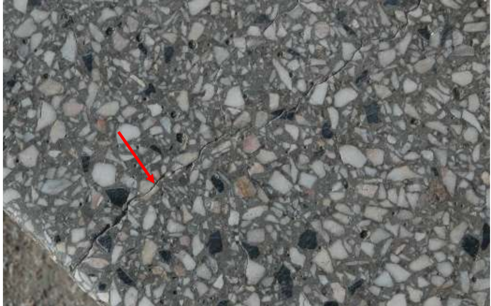
Fot. 6. Fragment stopnia: rysa o przebiegu równoległym do boku biegu schodów;
