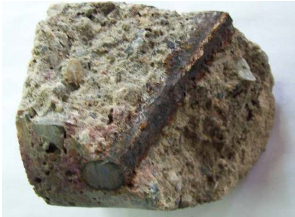
Fot. 38. Fragment odwiertu nr 2: pręt \varnothing 14 powierzchniowo skorodowany; struktura betonu porowata;
