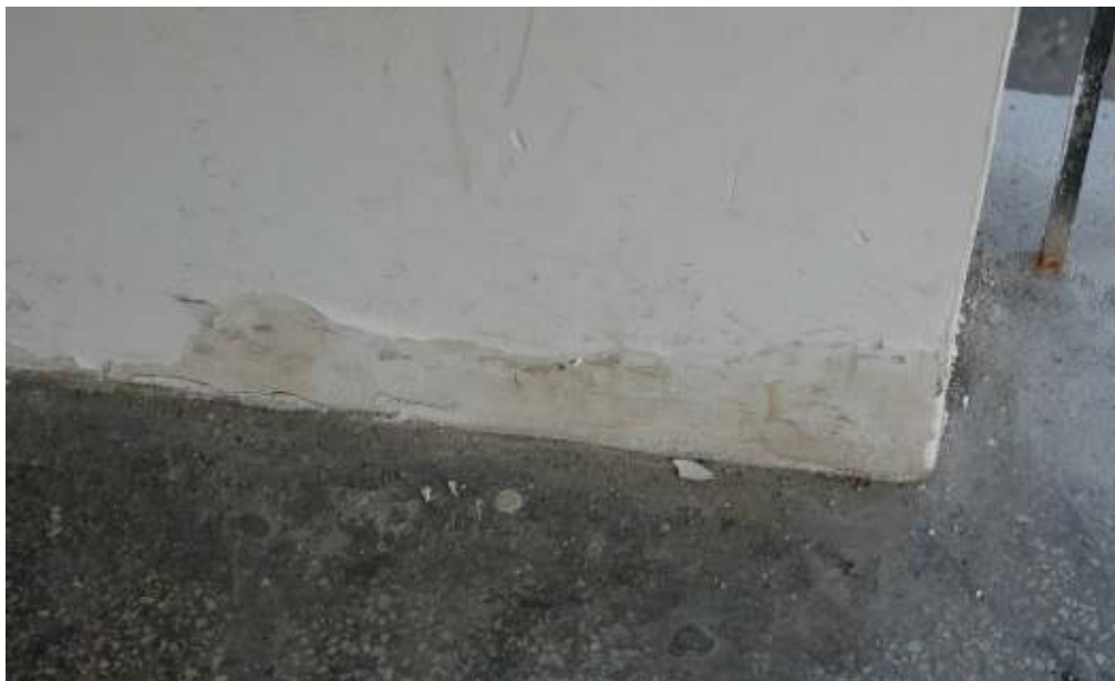
Fot. 27. Filar od strony wschodniej: zawilgoconie w dolnych partiach;
