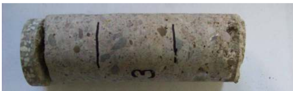
Fot. 36: Odwiert nr 3 o średnicy \varnothing 94 mm: beton od góry jest zagęszczony; od dołu jest porowaty o obniżonej wytrzymałości; warstwa lastryko odspojona od betonu
