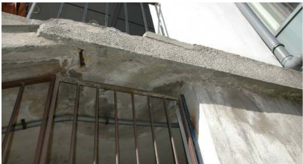
Fot. 15. Fragment spocznika: zawilgocone podniebienie spocznika; zacieki na powierzchni słupa; korozja odłoniętego zbrojenia;
