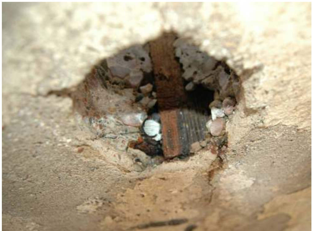
Fot. 25: Odwiert nr 4: drewniane pozostałości w bezpośrednim sąsiedztwie pręta zbrojeniowego;
