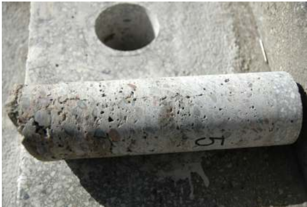
Fot. 23: Próbkę nr 5: pęknięcie przez całą wysokość; w dolnej części beton zawilgocony
