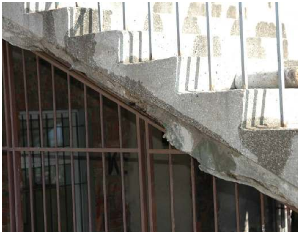
Fot. 9. Fragment biegu schodowego: ubytki betonu na bocznej powierzchni płyty biegowej.
