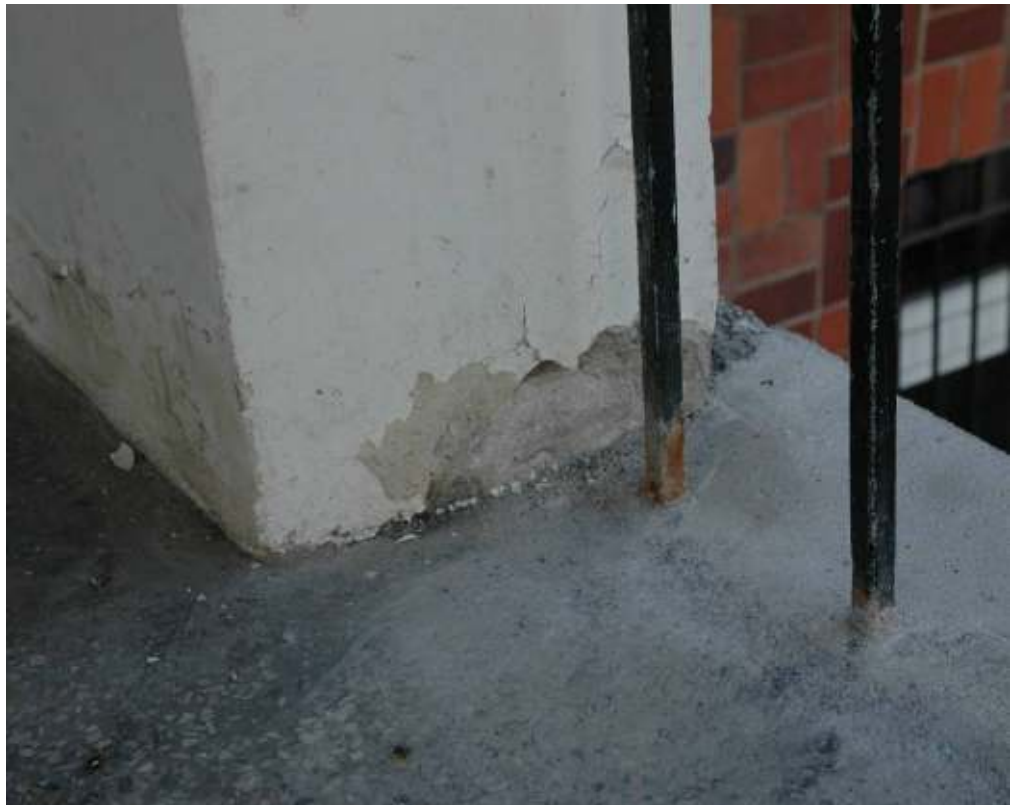
Fot. 28. Filar od strony wschodniej: zawilgocenie w dolnych partiach; - słupki metalowe balustrady powierzchniowo skorodowane;
