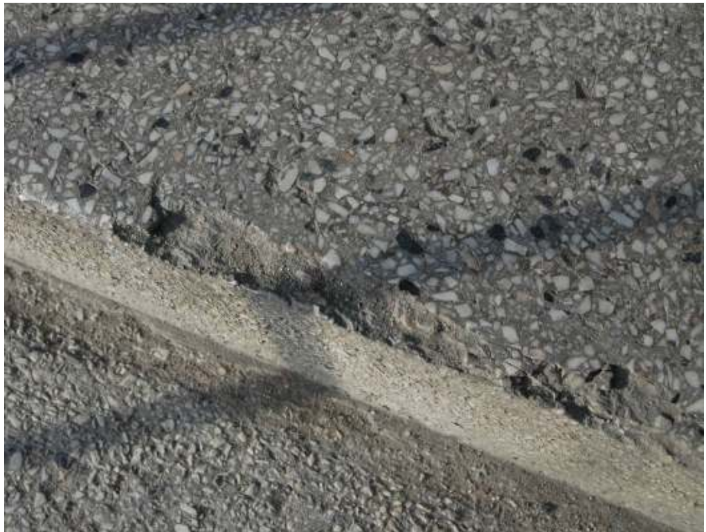
Fot. 8. Fragment stopnia: uszkodzenia okładziny lastrykowej na krawędzi stopnia.
