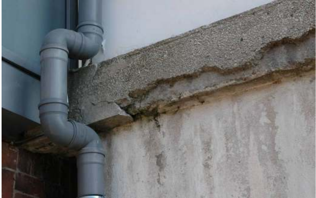
Fot. 14. Fragment spocznika: ubytki okładziny lastrykowej; zacieki na powierzchni słupa; złuszczenia farby;
