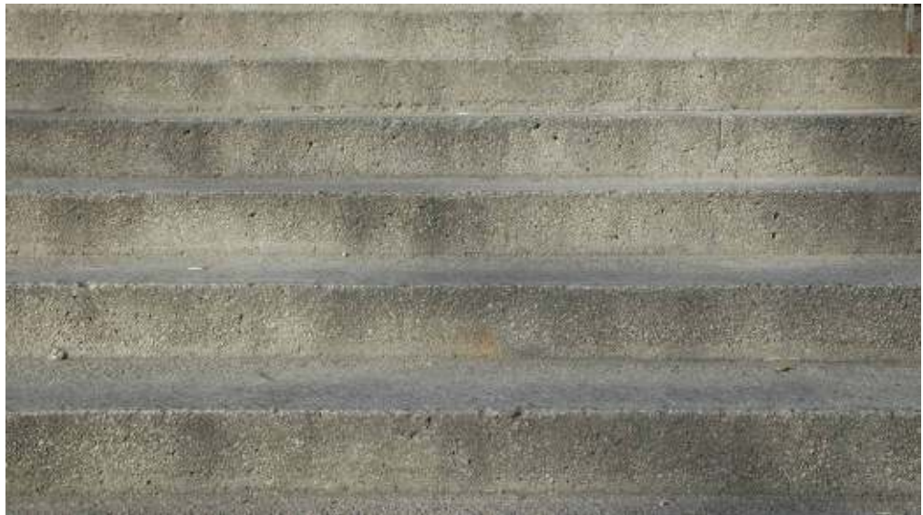
Fot. 4. Widok na stopnie: zacieki na podstopnicach; różnice w wysokościach stopni
