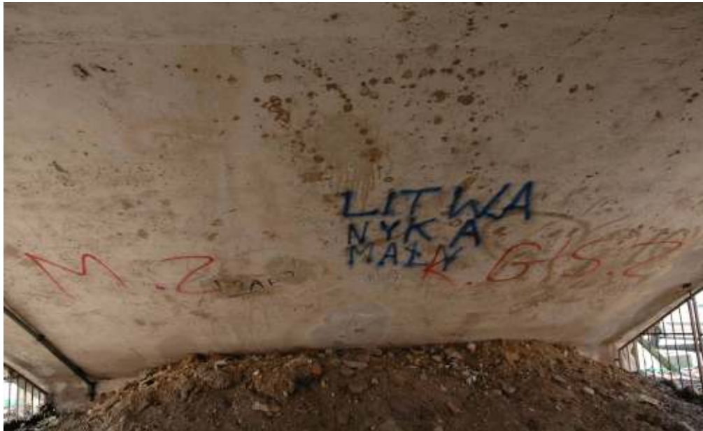
Fot. 17. Fragment podniebienia płyty biegowej: graffiti; zacieki na powierzchni tynku;
