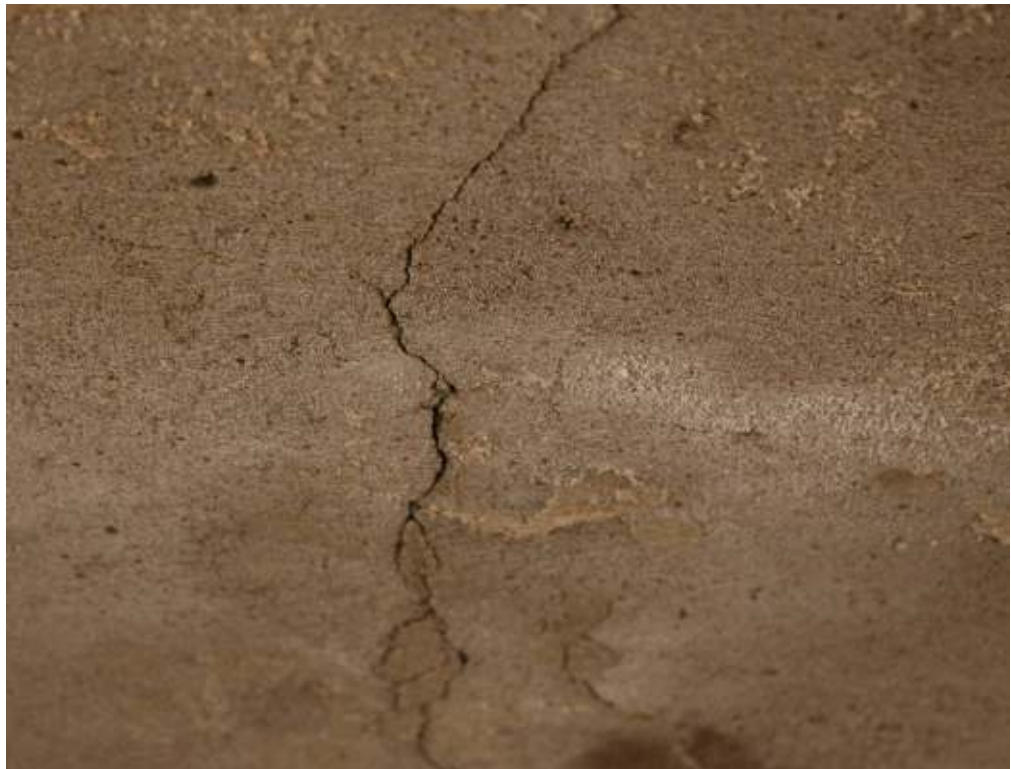
Fot. 19: Fragment podniebienia płyty biegowej: rysa o nieregularnym, pionowym przebiegu o rozwarciu do 1 mm;
