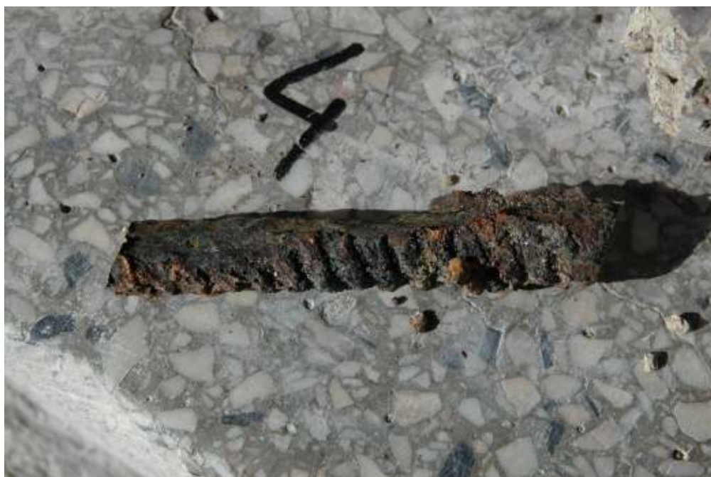
Fot. 40: Fragment odwiertu nr 4: pręt \varnothing 14 powierzchniowo, nierównomiernie skorodowany;
