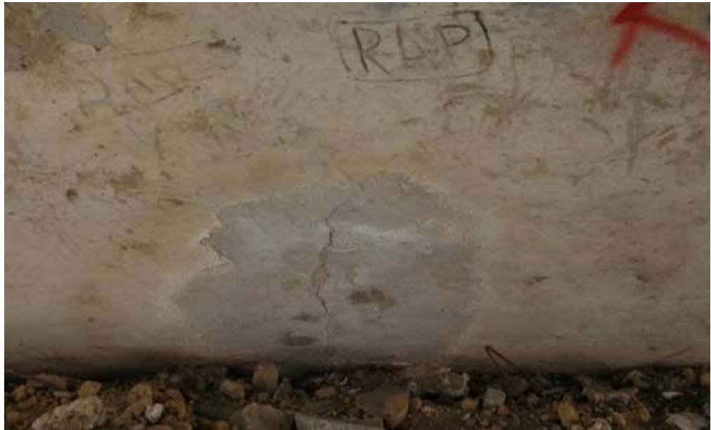
Fot. 18: Fragment podniebienia płyty biegowej: fragmentami tynk w przeszłości naprawiany;
