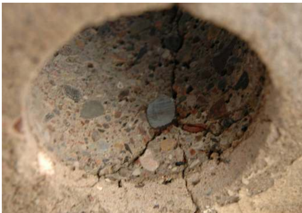
Fot. 37: Otwór nr 1: widoczny pręt zbrojenia głównego; promieniste spękania wokół pręta;
